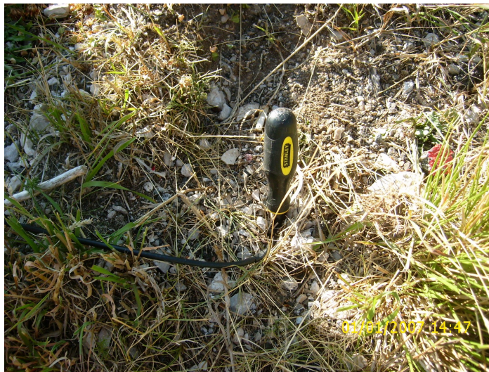
La "presa di terra": un semplice cacciavite conficcato nel terreno...
